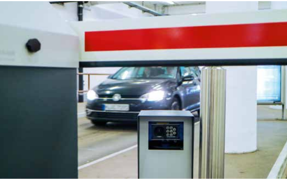
Kamera zur Kennzeichenerkennung an der Einfahrt im Parkhaus „Am Gericht“.
